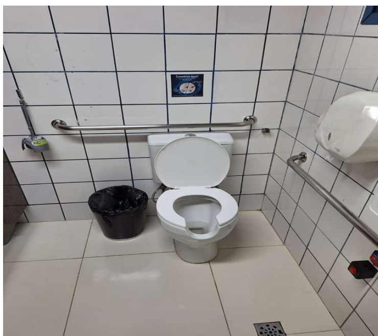
Figura 5 - Sanitário acessível, equipado com barras de apoio laterais, acionador de emergência e demais adaptações previstas nas normas de acessibilidade, na sede do TRT14 (Porto Velho/RO, 2025). Fonte: Auditoria Interna – SEAUDI, 2025
