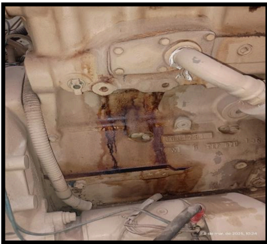
Figura 19: VAZAMENTOS CONTIDOS (REVISAR)
