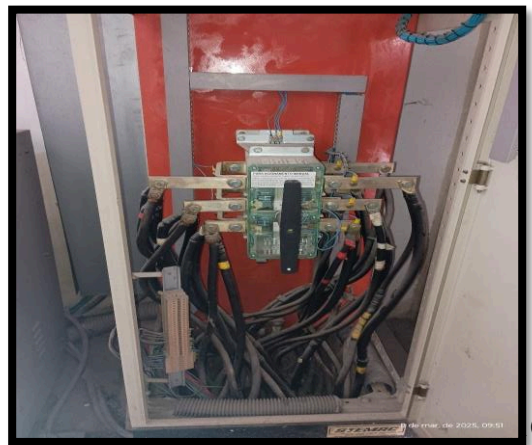
Figura 22: QUADRO DE TRANSFERÊNCIA AUTOMÁTICO - QTA PRÉDIO
