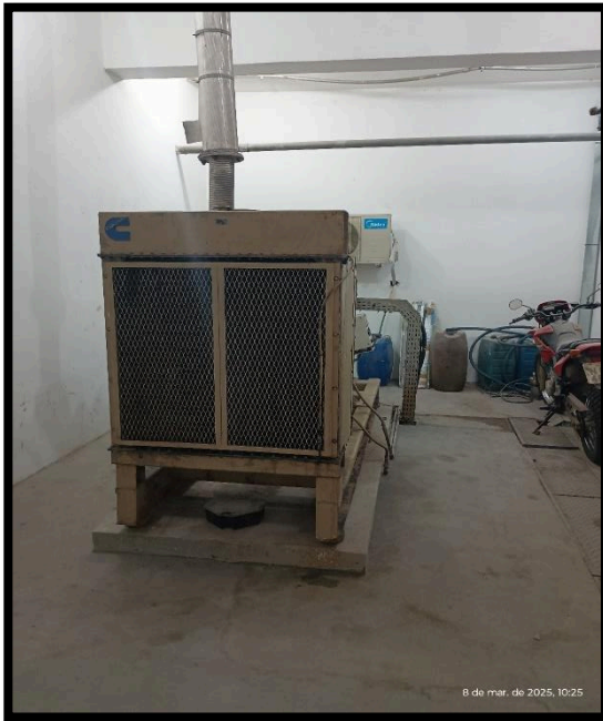
Figura 17: VISTA FRONTAL GERADOR STEMAC - PRÉDIO
