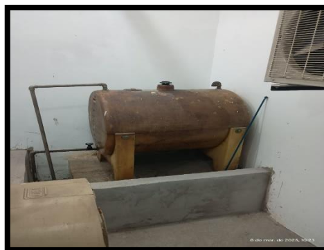
Figura 23: TANQUE DE COMBUSTÍVEL EXTERNO SEM PREVENTIVA
