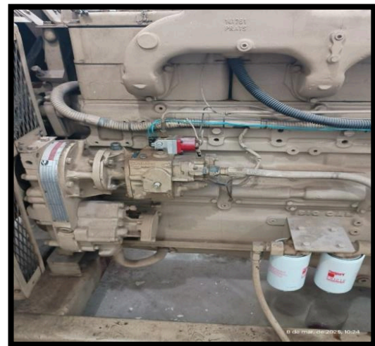
Figura 20: VISTA LATERAL - FIOS SOLTOS SEM PROTEÇÃO
