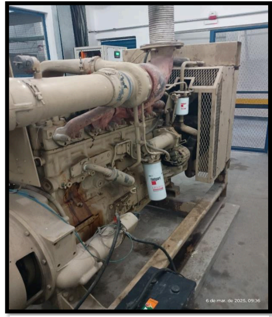
Figura 18: VISTA LATERAL - FIOS SEM PROTEÇÃO E VAZAMENTOS
