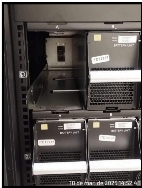
Figura 6: ALOJAMENTO BANCO DE BATERIAS - NORMAL
