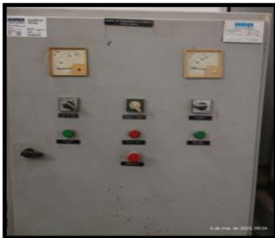
Figura 13: QUADRO DE TRANSFERÊNCIA AUTOMÁTICA - QTA
