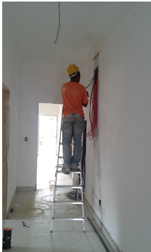
Ilustração 2: Passagem de cabeamento de rede lógica.
