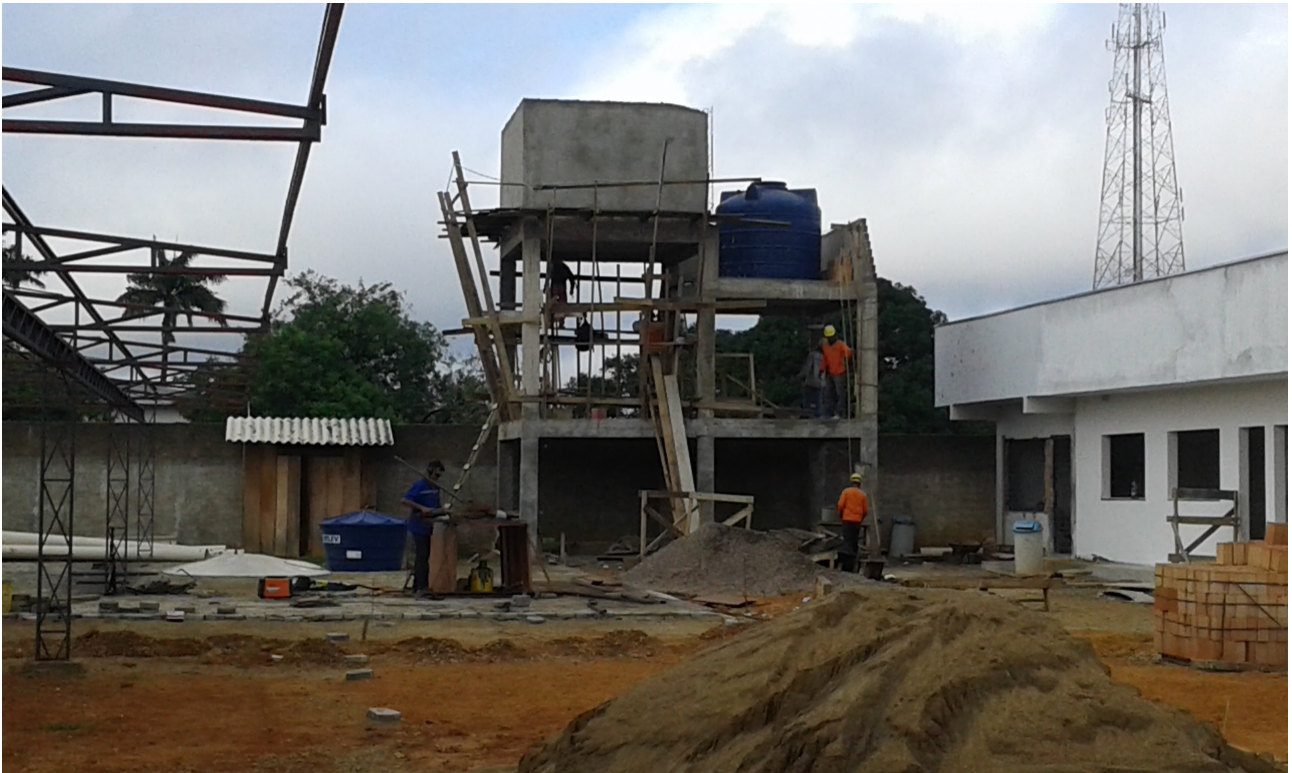
Ilustração 1: Parte posterior da obra em execução – estrutura metálica, bloquetes, reservatórios elevados e arquivos.
