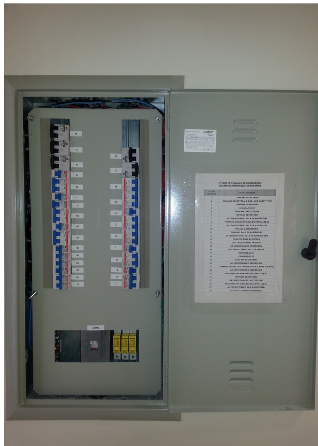
Ilustração 4: Quadro de distribuição de circuitos elétricos.
