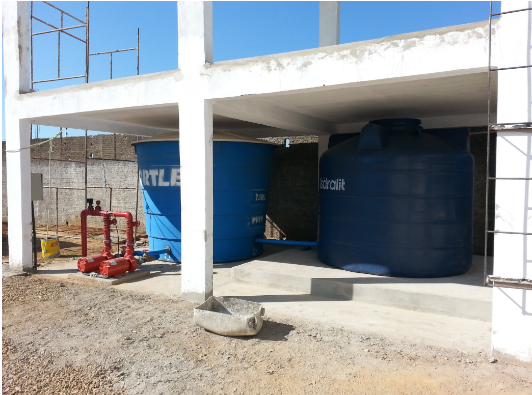
Ilustração 3: Reserva técnica e bombas de combate a incêndio.
