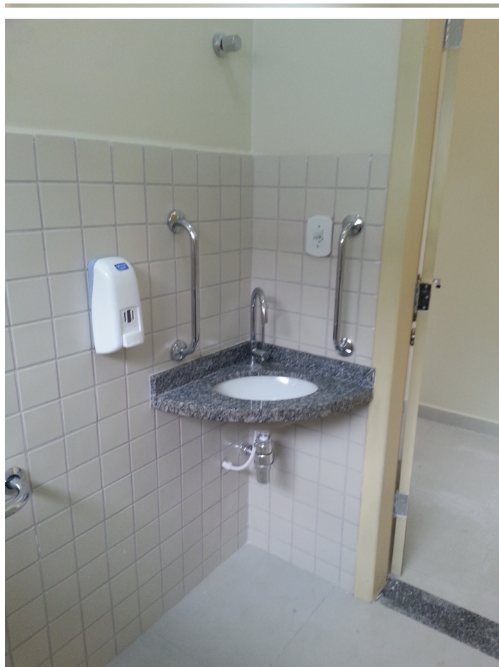
Ilustração 7: Lavatório em banheiro para pessoas com deficiência.
